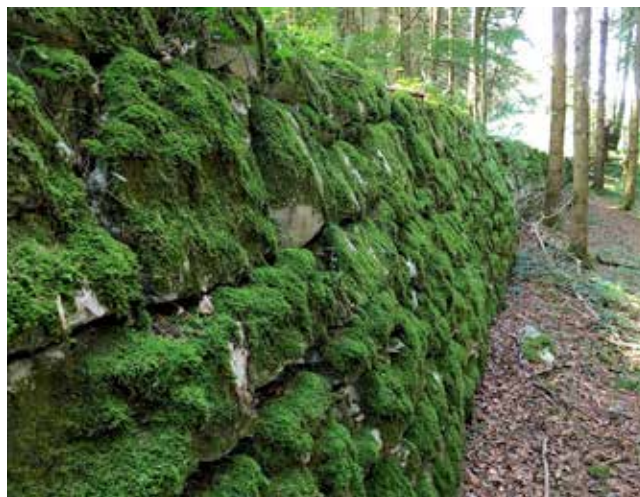
Mur de soutènement de la rampe d'accès dit Mur des scouts (Photo J. Michel)
